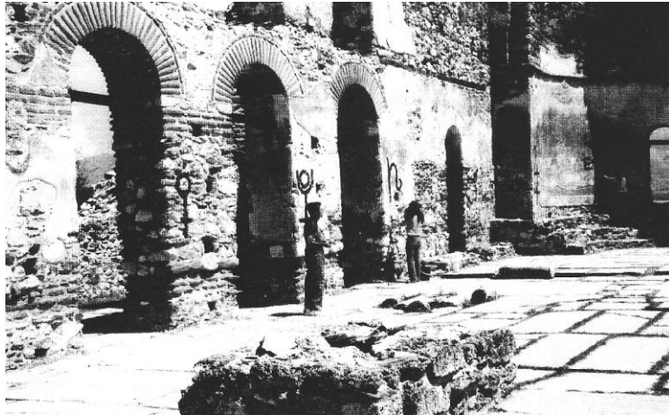
Εικόνα 2.34. Οι βανδαλισμοί στην τοιχοδομή της Βασιλικής του Αγίου Αχιλλείου τον Ιούλιο του 2006 (16 η ΕΒΑ 2006).
