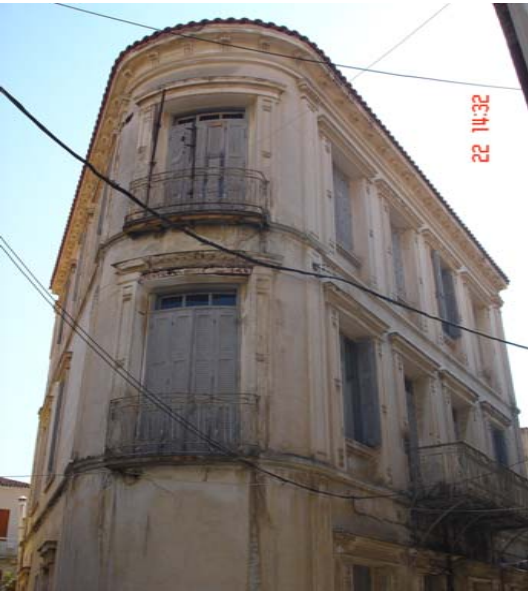
Φωτογραφία 4: Νεώτερο Μνημείο ( Ιδιοκτησία κ. Βασιλικής Πούλια) Η εγκατάληψη του κτηρίου είναι φανερή.
