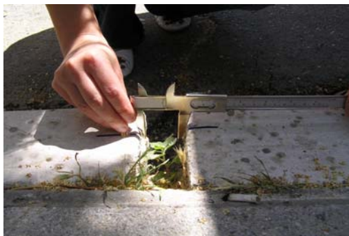
Φωτο 19) Μέτρηση του ανοίγματος των διαρρήξεων με παχύμετρο στο πεζοδρόμιο της οδού Μεγάλου Αλεξάνδρου, για την παρακολούθηση του φαινομένου. (Φώτο Λεωνίδας Τσιώκος)
