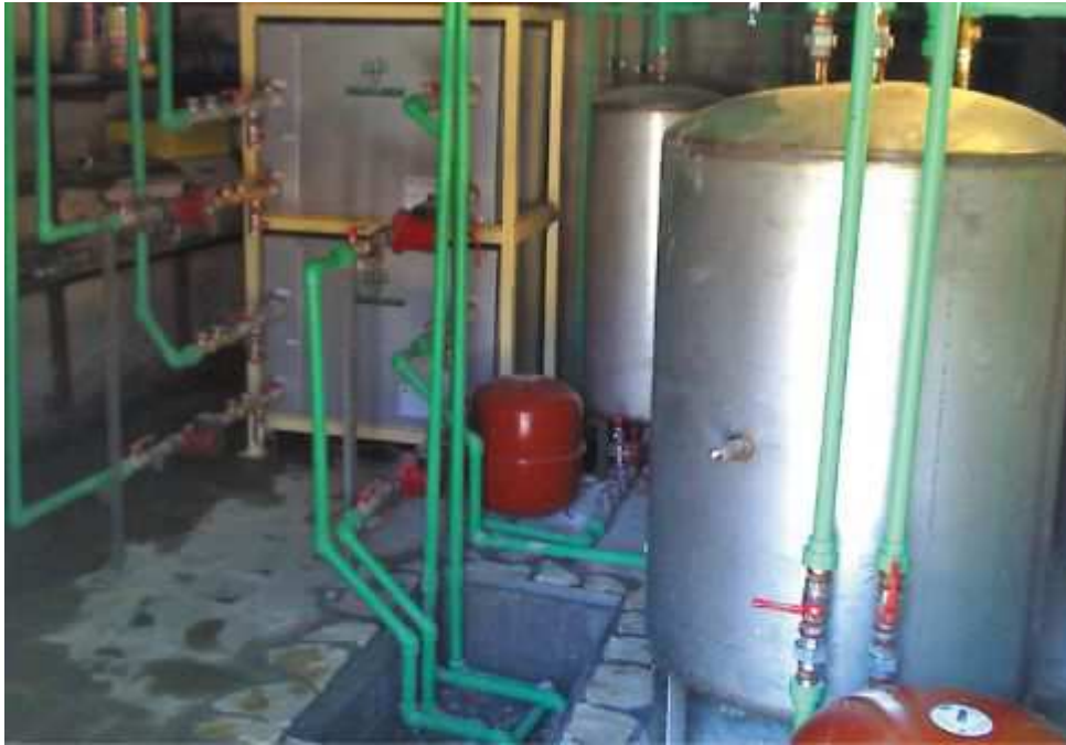
Εικόνα 37 Μηχανοστάσιο Γεωθερμικού Συστήματος
