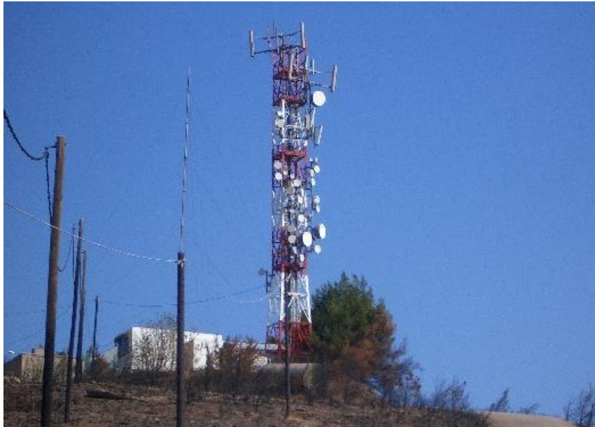
Εικόνα 5: Ένας τυπικός σταθμός βάσης
