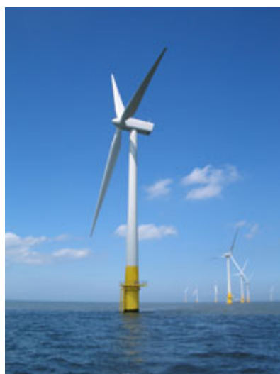
Σχήμα 3.1: Εικόνα ανεμογεννήτριας εγκατεστημένης στη θάλασσα. (Πηγή: www.bwea.com )
