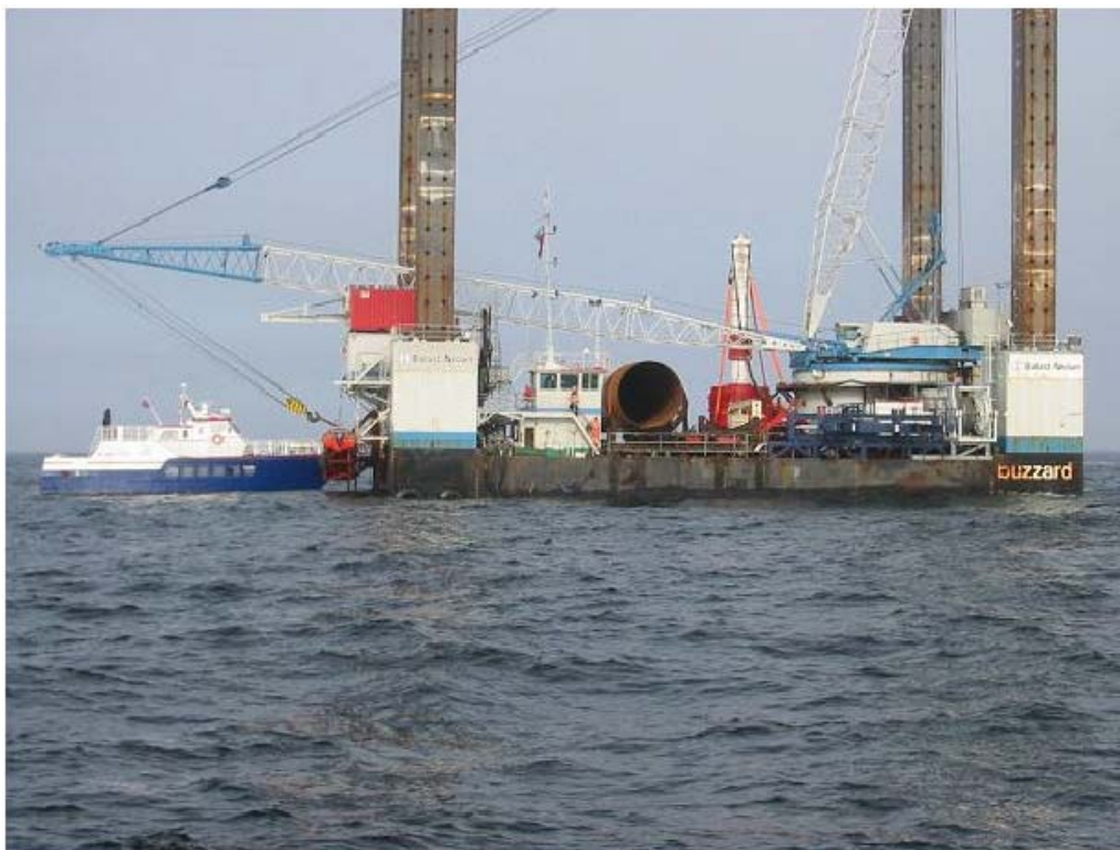
Σχήμα 1: Σε αυτή την εικόνα φαίνεται η πλωτή εξέδρα που έχει στηθεί για να κατασκευαστεί η υποβρύχια θεμελίωση του πύργου της ανεμογεννήτριας στον πυθμένα της θάλασσας.
