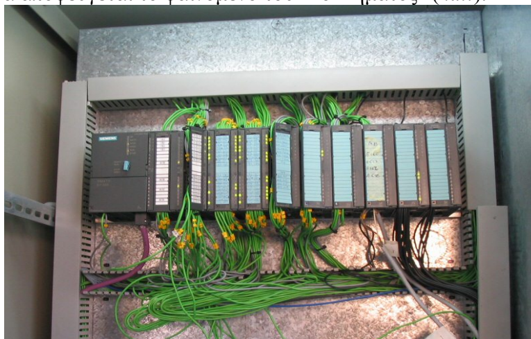
Εικόνα 2.2.3. Τοποθέτηση PLC εντός μεγάλου ηλεκτρικού πίνακα. Αριστερά η CPU S7-300 και δίπλα διακρίνονται 10 Modules. Η πράσινη λυχνία δεικνύει ότι η αντίστοιχη είσοδος ή έξοδος είναι ενεργοποιημένη.
