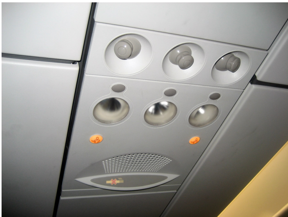
Εικόνα 4. 4: Ατομικοί αεραγωγοί στην καμπίνα του αεροσκάφους, τοποθετημένοι πάνω από τα καθίσματα των επιβατών.
