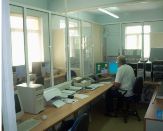
Εικόνα 5.10 Αίθουσα Ελέγχου Συστήματος Προσομοίωσης Μηχανοστασίου Πλοίου (ΚΕΣΕΝ Α.Ι.Ρέντης).
