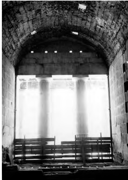
Εικ.61 Ο δυτικός τοίχος του οπισθόδομου με το άνοιγμα της θύρας που διανοίχτηκε κατά τη μετατροπή σε χριστιανική εκκλησία, όπως υπήρξε κλεισμένο με λιθοδομή (Agora.ascsa.net).
