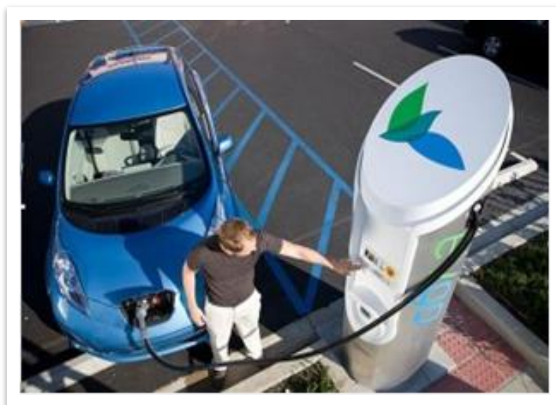
Εικόνα 27 Φόρτιση ηλεκτρικού αυτοκινήτου σε σταθμό ανεφοδιασμού (Park and Charge - PAC)
