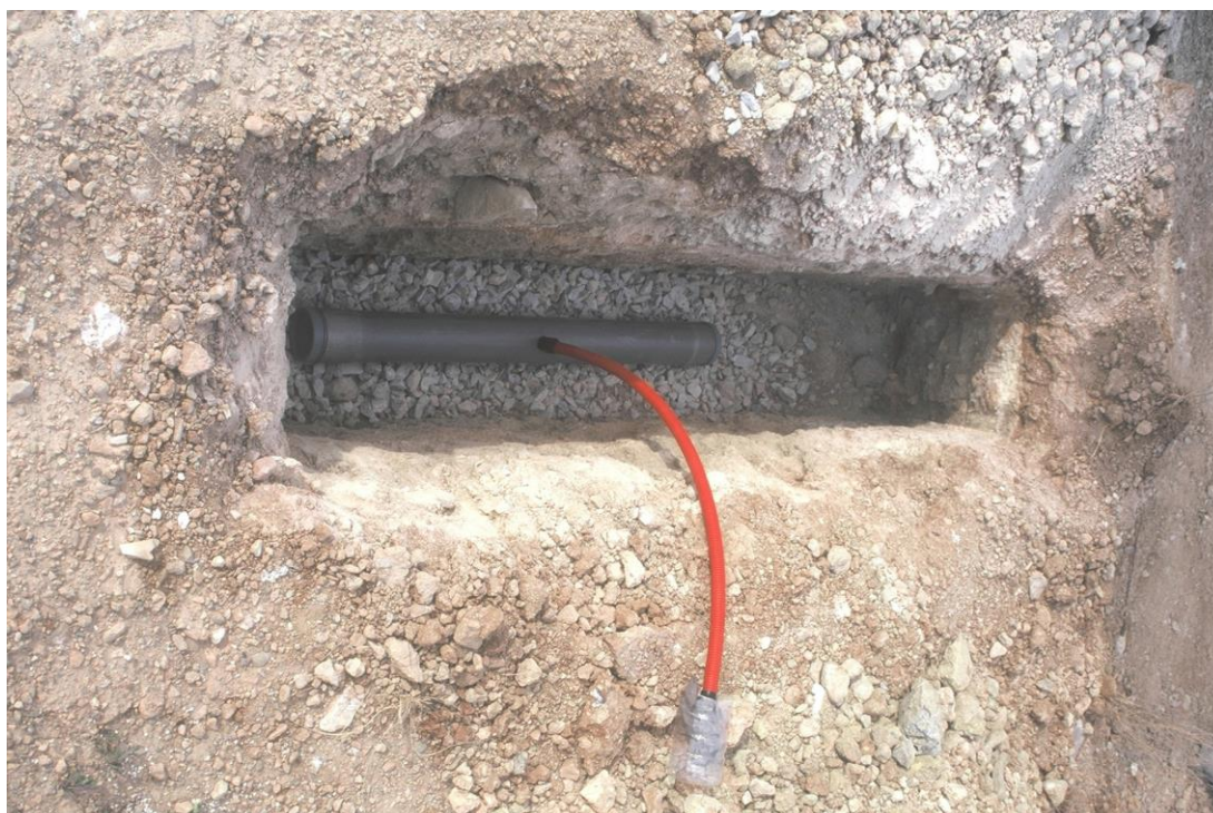
Φωτογραφία 7: Σταθμός μέτρησης της αέριας φάσης του εδάφους, βάθους 30 cm στην Π2.
