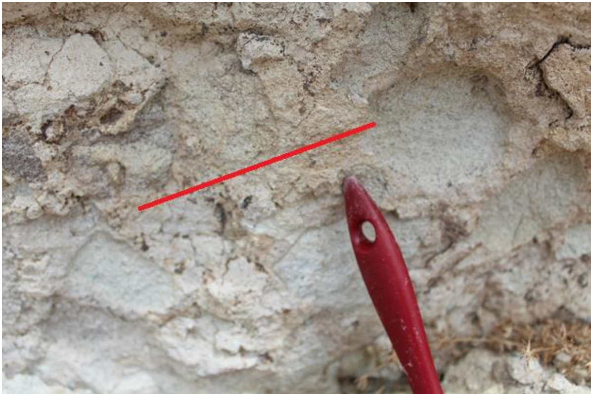
Εικόνα 276: Γράμμιση τεκτονικής ολίσθησης.
