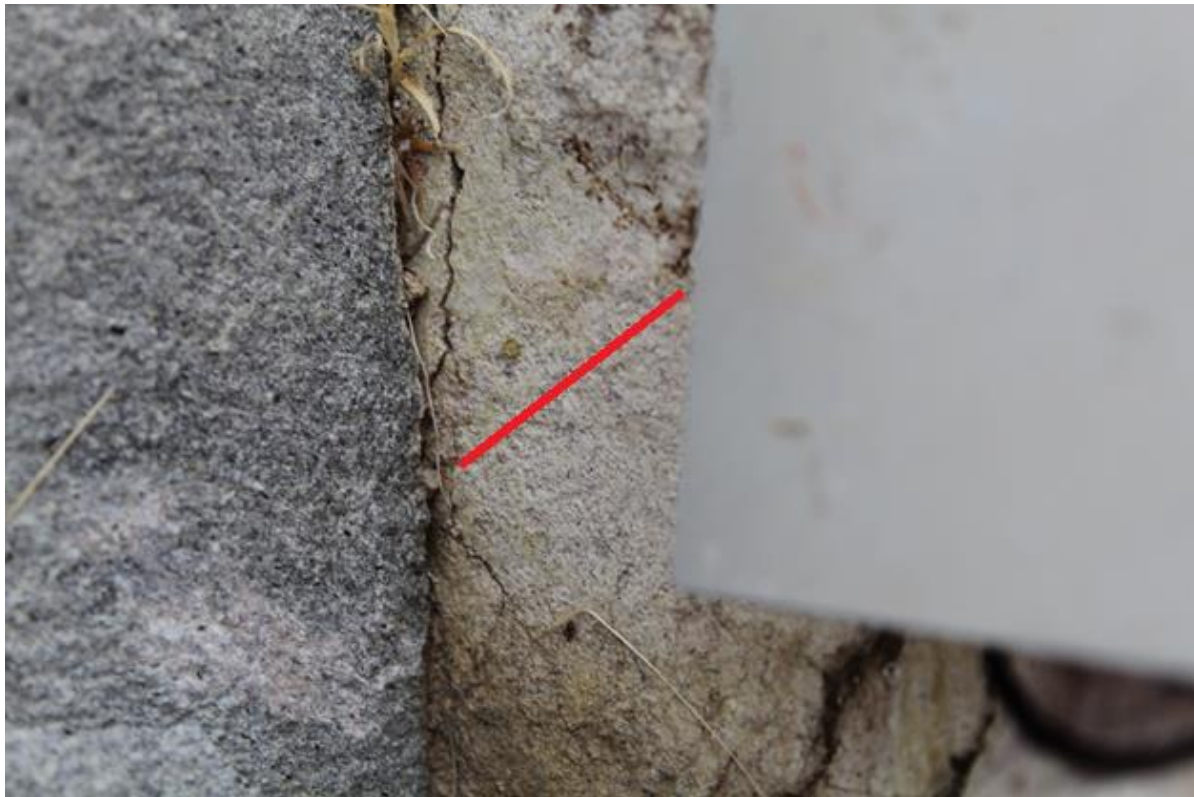
Εικόνα 240: Γράμμιση τεκτονικής ολίσθησης.
