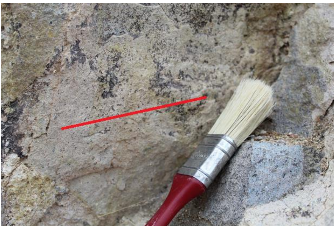
Εικόνα 263: Γράμμιση τεκτονικής ολίσθησης.
