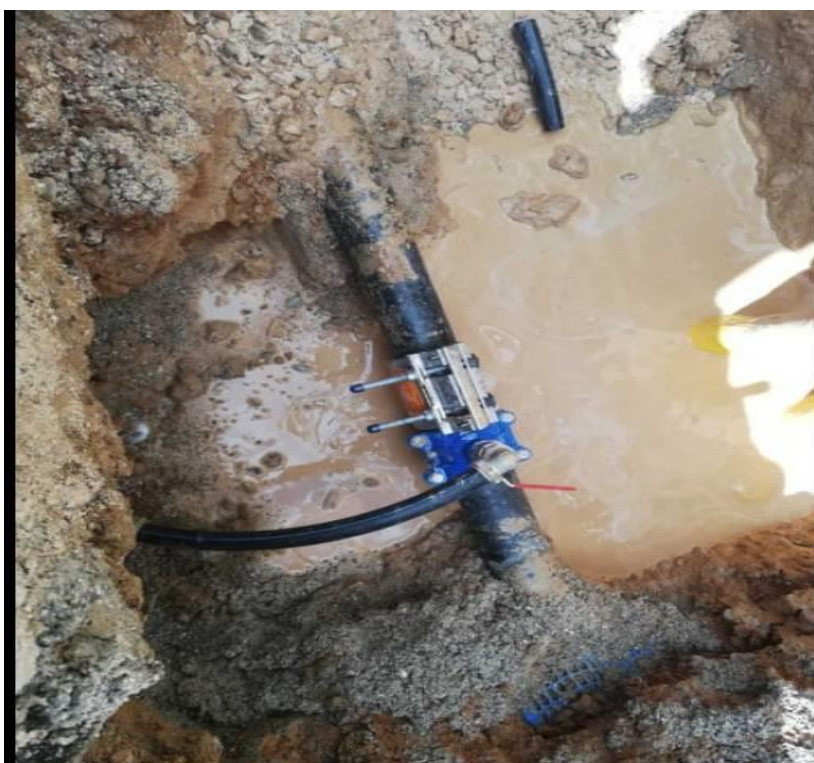
Εικόνα 22. ΑΠΟΚΑΤΑΣΤΑΣΗ ΔΙΑΡΡΟΗΣ ΣΕ ΑΓΩΓΟ ΔΙΑΝΟΜΗΣ ΜΕ ΤΟΥΣ ΜΕΤΡΗΤΕΣ ΤΩΝ ΚΑΤΑΝΑΛΩΤΩΝ ΤΗΣ Δ.Ε.Υ.Α.Ρ.
