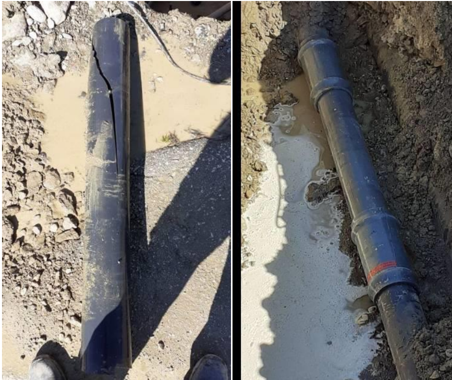
Εικόνα 21 ΘΡΑΥΣΗ ΑΓΩΓΟΥ ΥΔΡΕΥΣΗΣ ΕΠΙΣΚΕΥΑΣΜΕΝΟΣ ΑΓΩΓΟΣ ΔΙΚΤΥΟΥ Δ.Ε.Υ.Α.Ρ. ΔΙΚΤΥΟΥ Δ.Ε.Υ.Α.Ρ
