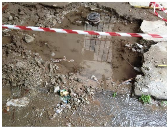
Εικόνα 20. Διαρροή από θραύση αγωγού ύδρευσης.
