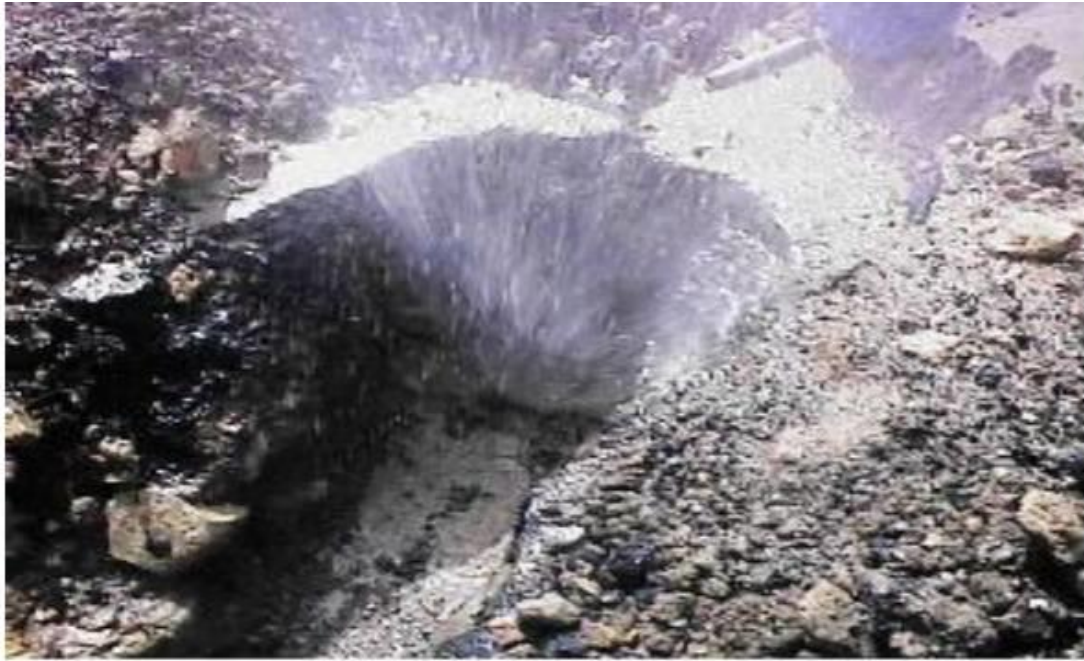
Εικόνα 15. Διαρροή κεντρικού αγωγού .
