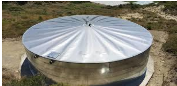
Εικ. 42 Δεξαμενή σύνδεσης με τον κεντρικό αγωγό φράγματος "Γαδουρά" στην περιοχή των Κολυμπίων χωρητικότητας 1000 μ 3 .
