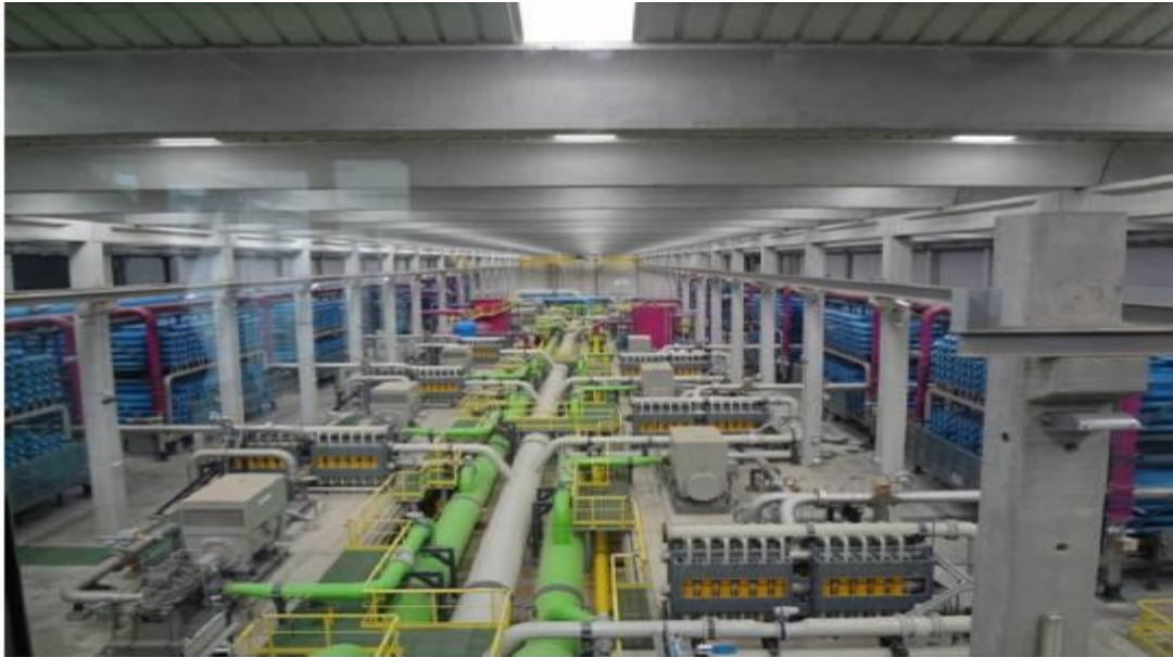
Εικ. 13 Μονάδα αφαλάτωσης με αντίστροφη ώσμωση
