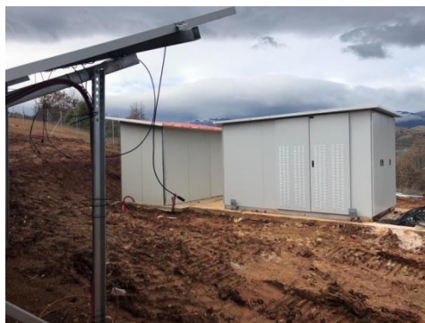
Εικόνα 21. Υποσταθμός μέσης τάσης και βοηθητικός οικίσκος.
