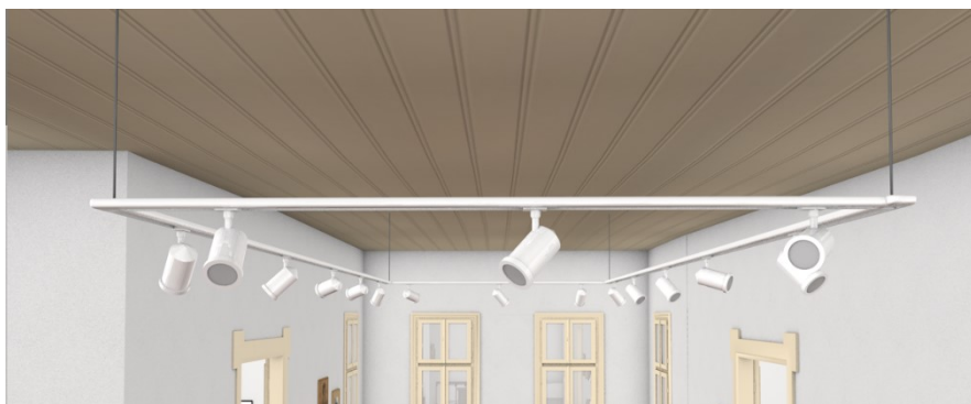
Εικόνα 1076. Φώτα στον διάδρομο του ανώτερου ορόφου.
