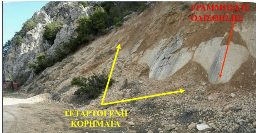
Εικόνα 22: Φωτογραφία του ρήγματος των Σερβιών- Βελβεντού (από http://tkm.tee.gr )
