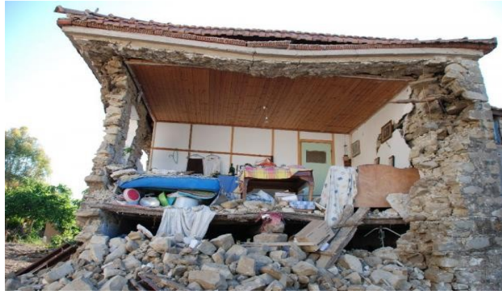
Εικόνα 8. Φωτογραφία που απεικονίζει την καταστροφή που υπέστη ένα οίκημα στην περιοχή της Ανδραβίδας. (πηγή http://www.tovima.gr/2019/07/19/society/oi-megalyteroi-seismoι-pou-exoun-simeiothei-stin-ellada/ )
