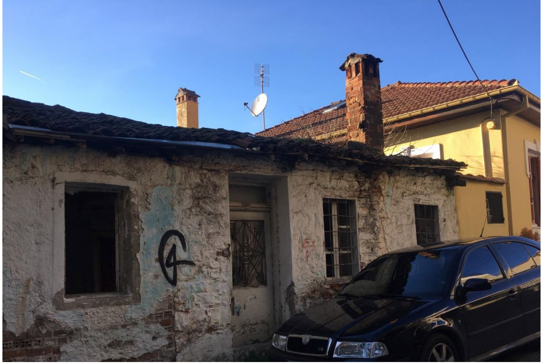
Εικόνα 3, Φωτογραφία συμμετέχουσας Μ, Εγκαταλειμμένο σπίτι με επικίνδυνα χαρακτηριστικά που ενδέχεται να προκαλέσει ζημιές σε σταθμευμένα αυτοκίνητα.
