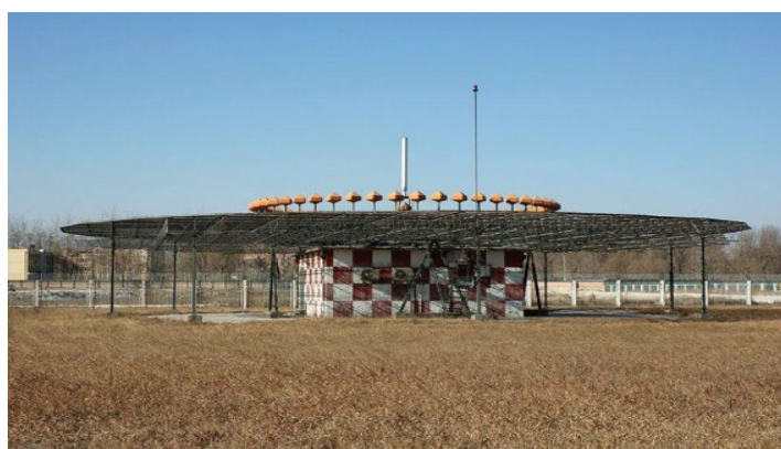
Σχήμα 3. 51: Σταθμός εκπομπής VOR/VORTAC
