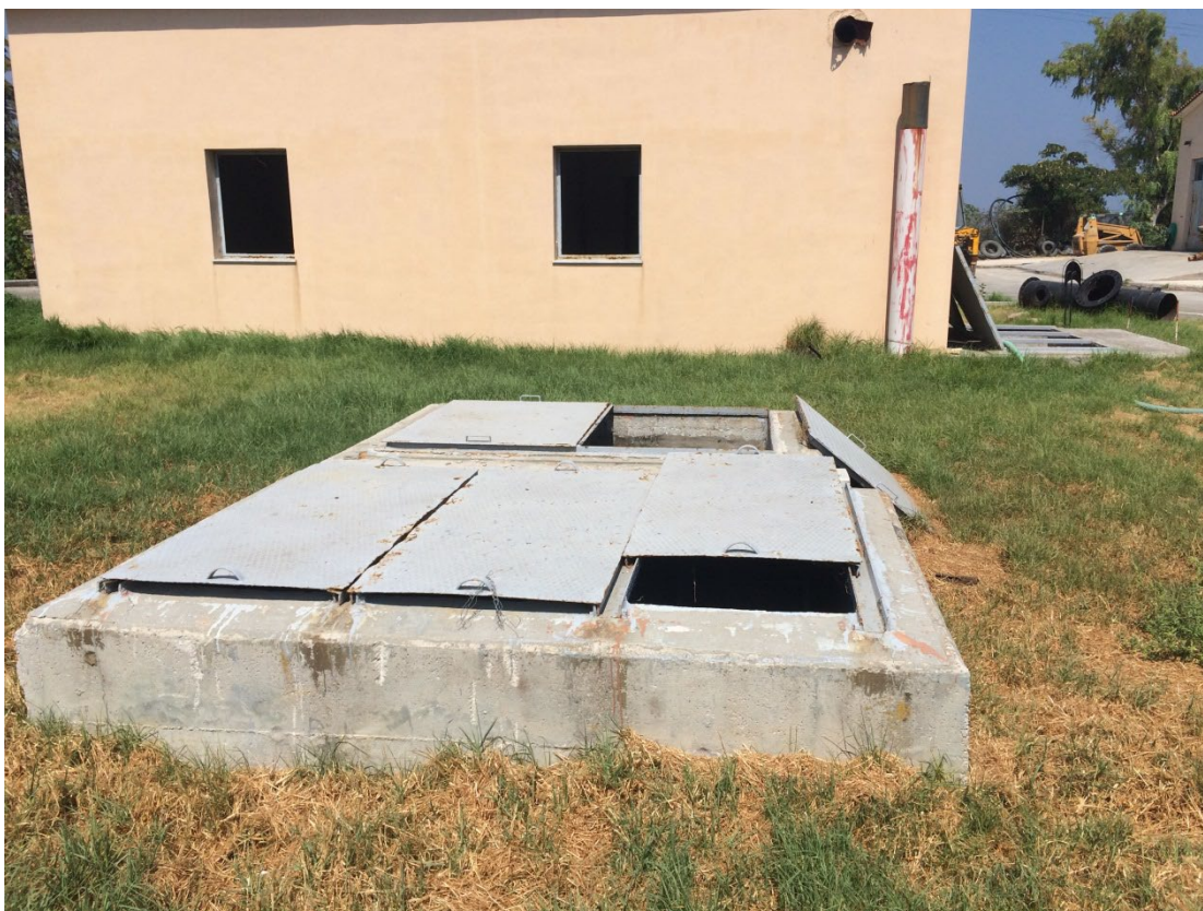
Εικόνα 1 - Φρεάτιο υποδοχής βοθρολυμμάτων (φωτογραφία συγγραφέα)
