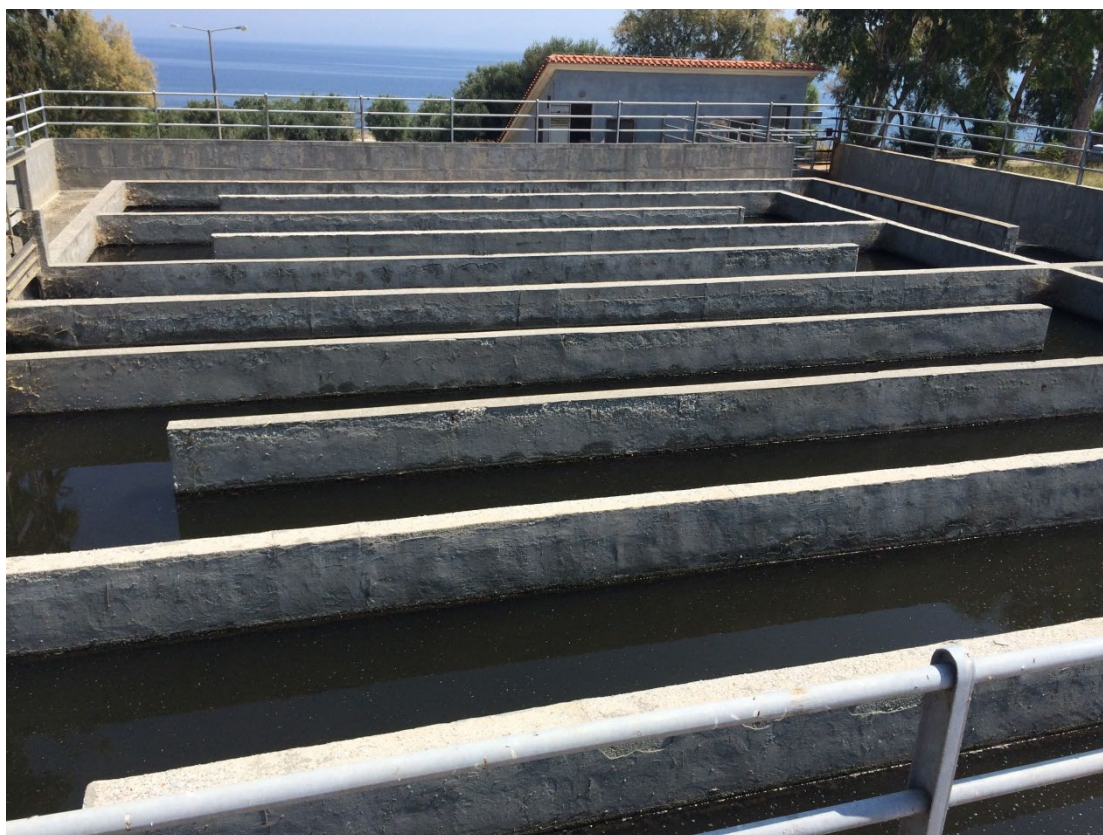
Εικόνα 8 - Δεξαμενή χλωρίωσης (φωτογραφία συγγραφέα)
