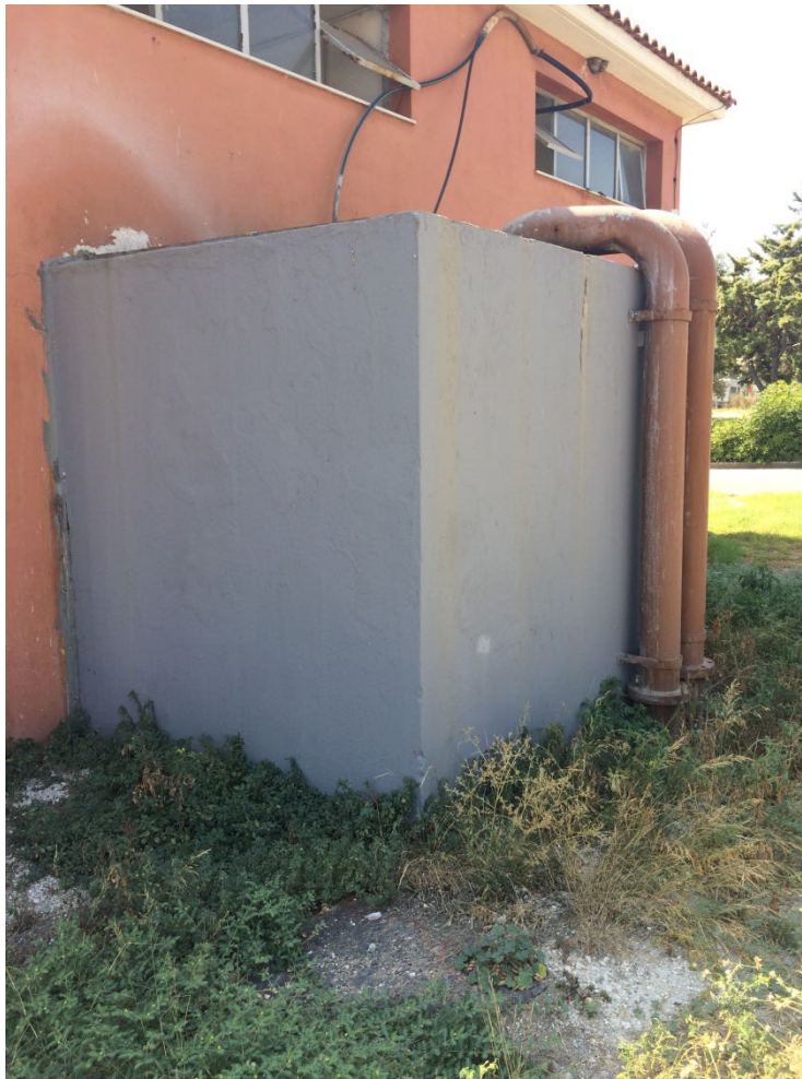
Εικόνα 2 - Φρεάτιο εισόδου (φωτογραφία συγγραφέα)
