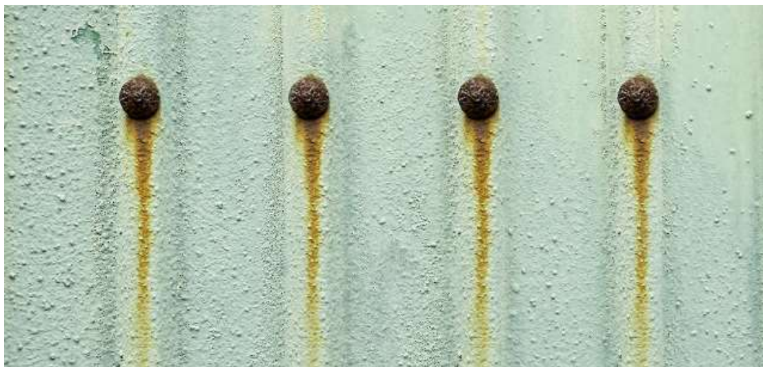
Εικόνα 4 : Μορφή Γαλβανικής διάβρωσης
