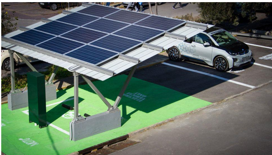
Εικόνα 3.21: Όψη του Αυτόνομου Σταθμού Φόρτισης Ηλεκτρικών Αυτοκινήτων στον χώρο του ΔΕΙ Πειραιά ΤΤ
