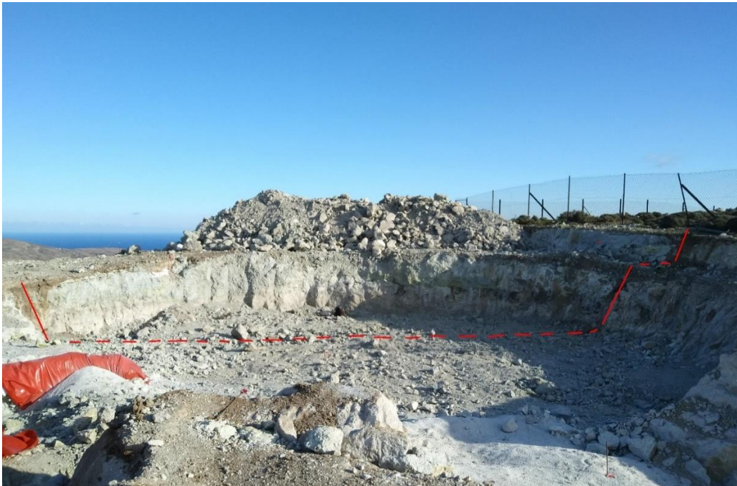
Εικόνα 30. Το ρήγμα στο σκάμμα της βάσης της ανεμογεννήτριας 1
