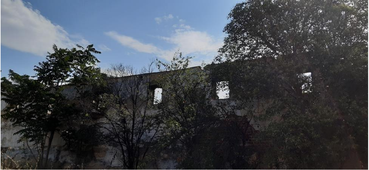
Εικόνα 44: Παρά-Θυρα στους τοίχους!. Οπτική εγκαταλελειμμένου κτηρίου με παράθυρα του στρατοπέδου Φωτ. ερευνήτριας, Στρατόπεδο Παύλου Μελά, Θεσσαλονίκη 2020
