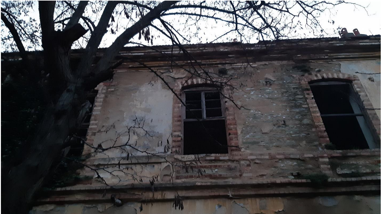
Εικόνα 29: Το ερείπιο ως ύπαρξη. Οπτική εγκαταλελειμμένου κτηρίου στο χώρο του στρατοπέδου. Φωτ. παραχώρηση του καλλιτέχνη/ερευνώμενου Δ. Στρατόπεδο Παύλου Μελά, Θεσσαλονίκη 2020
