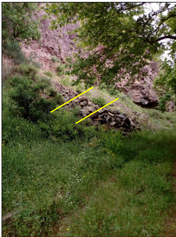
Εικόνα 32 Καταπτώσεις βράχων σε πρανές δακτικίας λάβας
