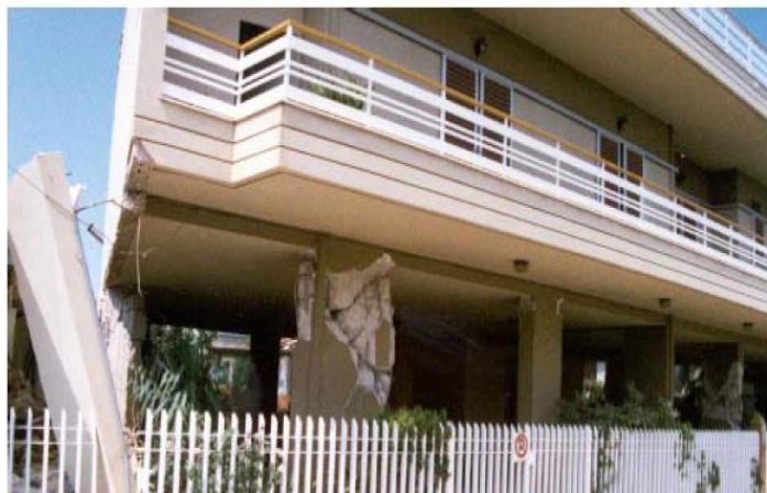
Εικόνα 7. 12 Κτίριο το οποίο υπέστη βλάβες στα στοιχεία του εξ' αιτίας της ασύμμετρης κατανομής, της δυσκαμψίας σε κάτοψη, και της ύπαρξης πυλωτής
