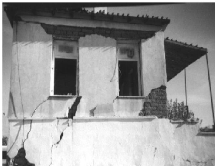
Εικόνα 7. 11 Παλαιά κατασκευή από φέρουσα τοιχοποιία, με εμφανείς σημαντικές βλάβες από το σεισμό
