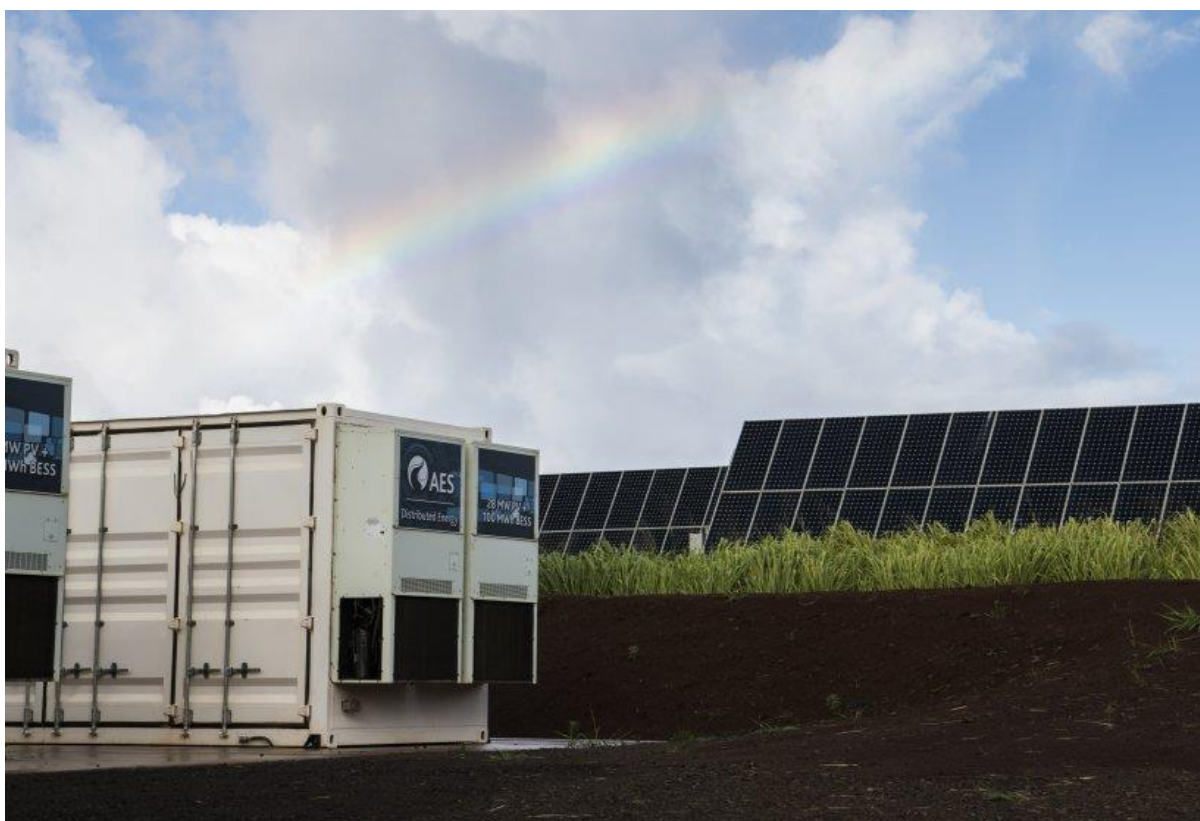
Σχήμα 2.4 : Συσσωρευτές εγκατεστημένοι Φωτοβολταϊκό Σταθμό Παραγωγής Ηλεκτρικής Ενέργειας ( https://www.energy.gov/eere/solar/solar-integration-solar-energy-and-storage-basics )
