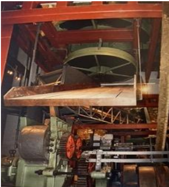
Εικόνα 42 Ατμολέβητας του εργοστασίου
