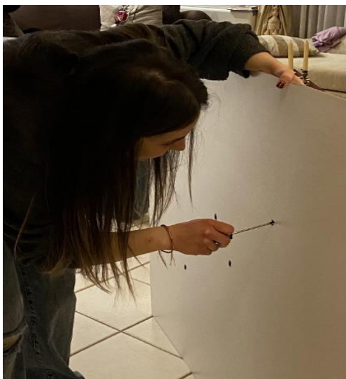
Εικόνα 76 Βίδωμα στην μπροστά πλευρά του πίνακα
