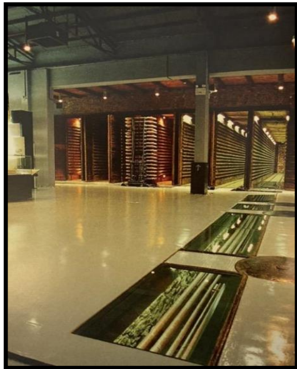
Εικόνα 46 Ο δρόμος προς τα ξηραντήρια- Τα γυάλινα σημεία στο πάτωμα φανερώνουν τους υποδαπέδιους αγωγούς μεταφοράς ατμού για να βοηθηθεί η διαδικασία της ξήρανσης
