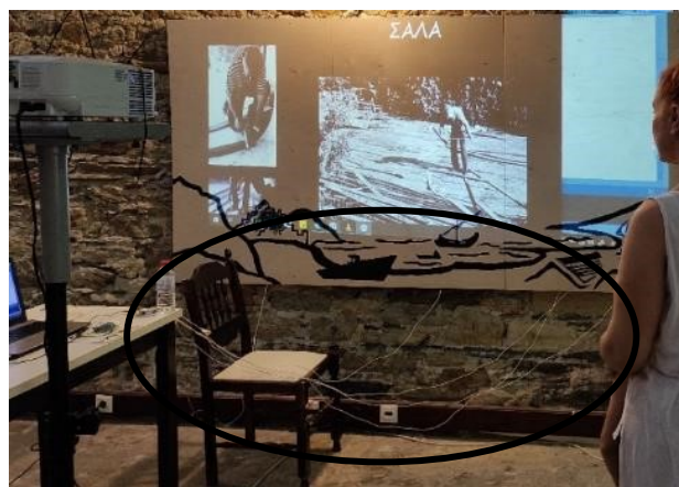
Εικόνα 5.10: Στον κύκλο διακρίνονται οι συνδεσμολογίες μεταξύ πλακέτας – κόντρα πλακέ. Είναι φανερή η επικινδυνότητα και η δυσκολία προσέγγισης του επισκέπτη.
