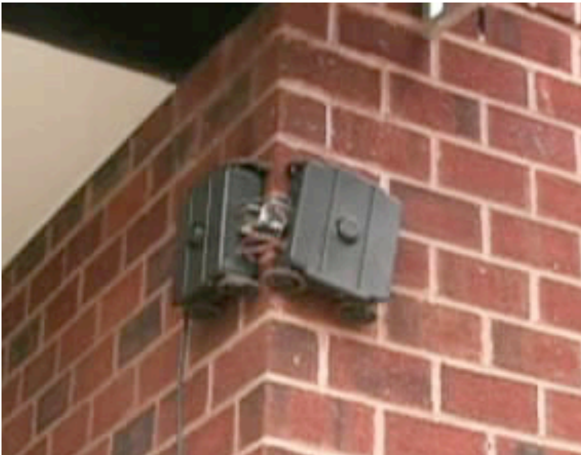
Εικόνα 4—1 Κίνηση κατακόρυφη στον τοίχο.
